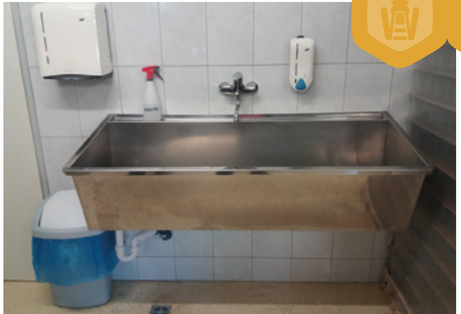
Abb. 09 - Spülwanne mit fließend Warm- und Kaltwasser
