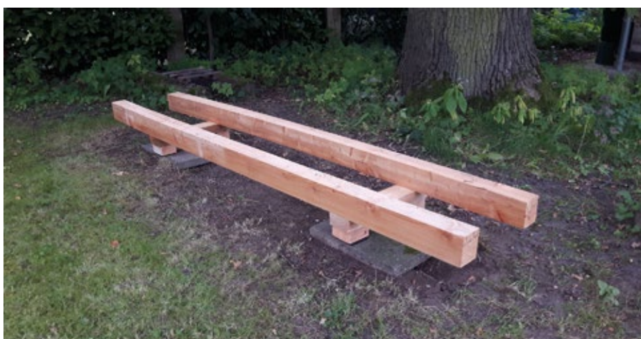
Abb. 07 - Das Untergestell ist stabil und standsicher. Foto: H. Schäfer
